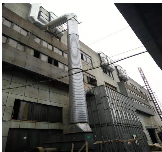
粉尘处理装置(中央布袋除尘系统)
