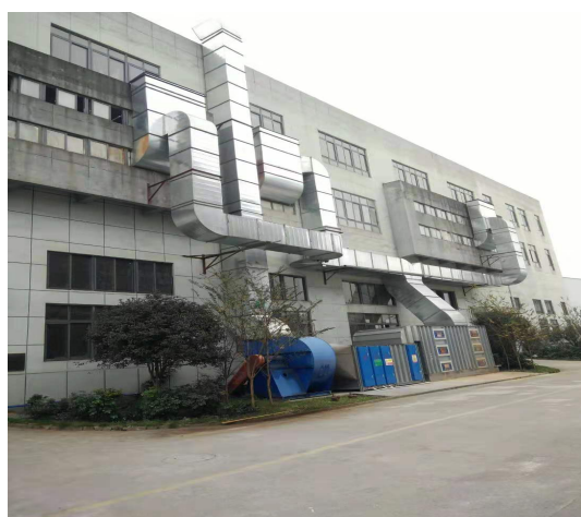
底漆废气处理装置
