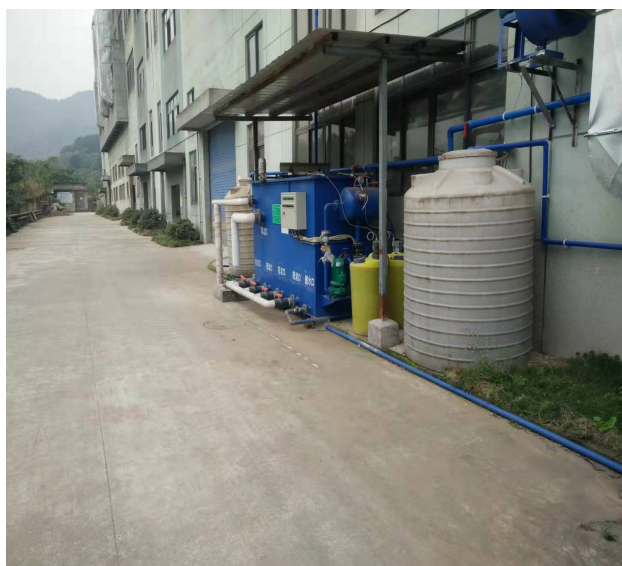
喷漆废水处理装置
