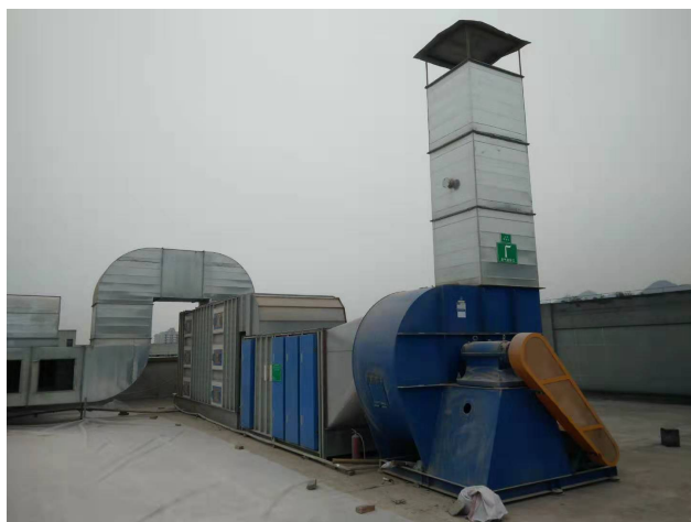
面漆废气处理装置
